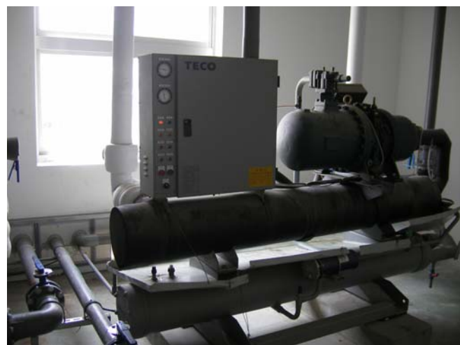
空調-冰水主機
