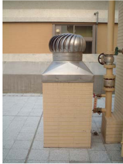
屋頂排風設備
