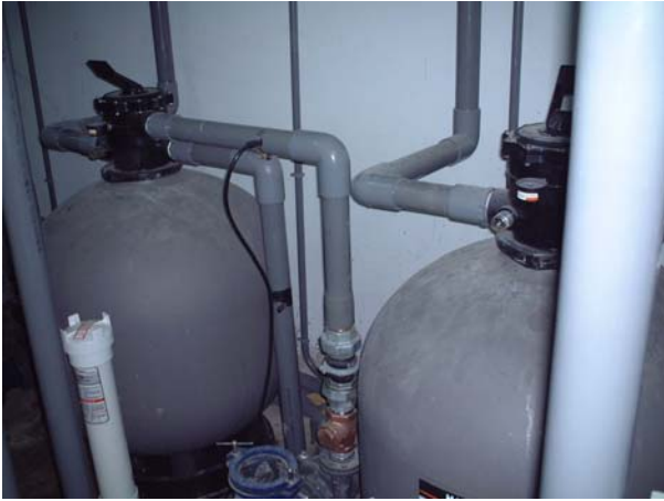
游泳池過濾筒
