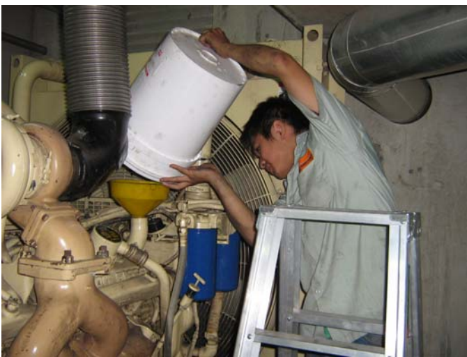
發電機更換機油
